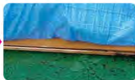
外部への漏れは微小
